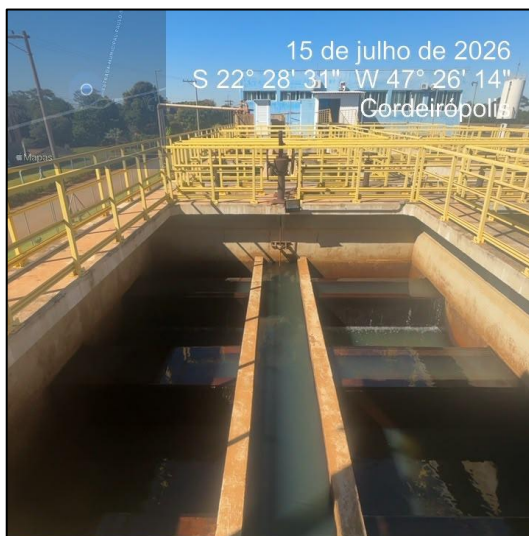
Figura 9 – Tanques de filtração, em Cordeirópolis.
