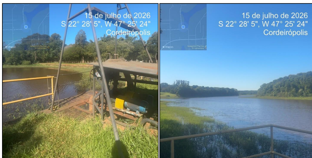
Figura 5 - Captação de água superficial para abastecimento público na Represa do Cascalho.
