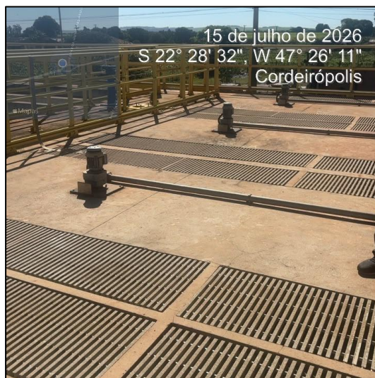
Figura 7 – Tanques de coagulação e floculação, em Cordeirópolis.
