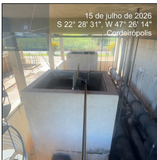
Figura 11 – Caixa de equilíbrio da ETA Cordeirópolis.
