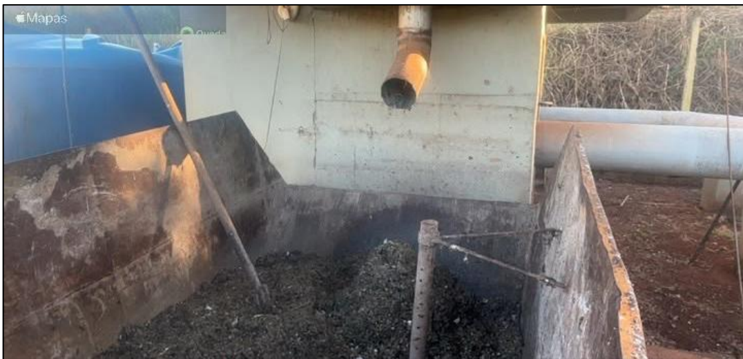
Figura 20 – Sistema de Desarenação da ETE Cordeirópolis.
