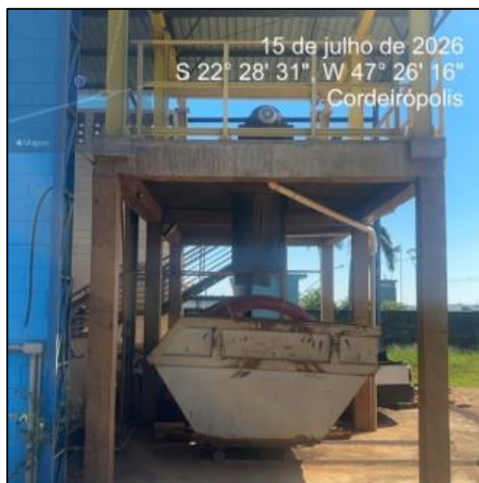
Figura 12 – Final do tratamento da ETA Cordeirópolis.
