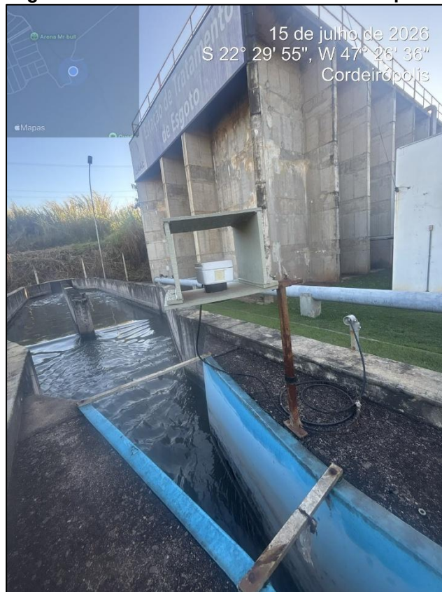
Figura 21 – Calha Parshall da ETE Cordeirópolis.
