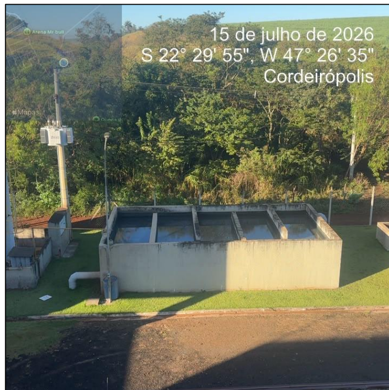
Figura 24 – Tanque de contato e sistema de cloração da ETE Cordeirópolis.
