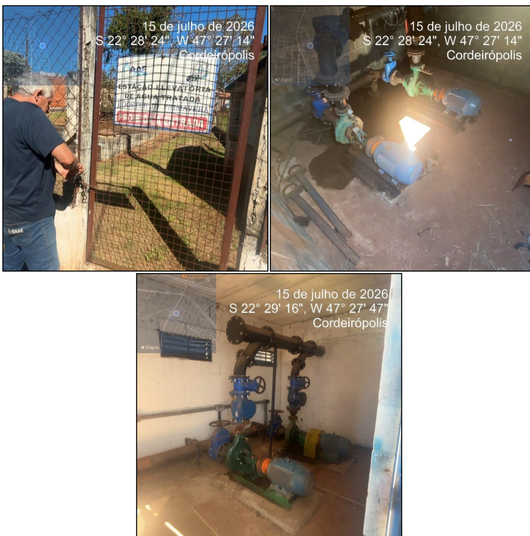
Figura 166 – Estação Elevatória em Cordeirópolis.
