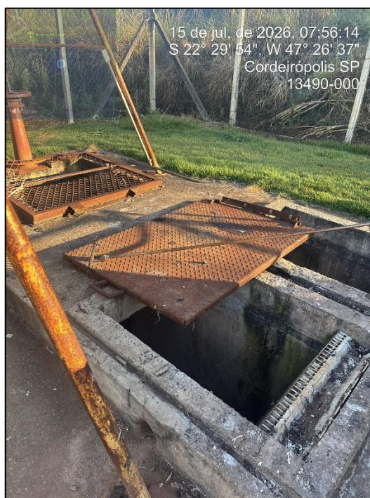
Figura 18 – Estação elevatória de esgoto bruto.
