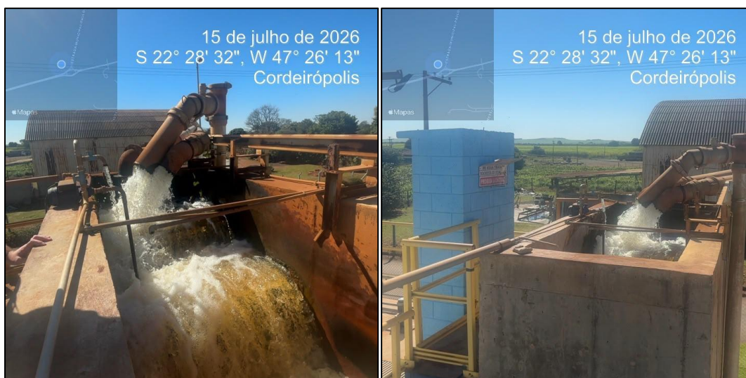
Figura 6 – Tanque de desinfecção preliminar (cloração e alcalinização).
