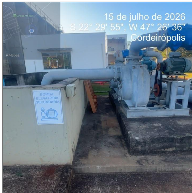
Figura 22 – Bomba elevatória secundária.
