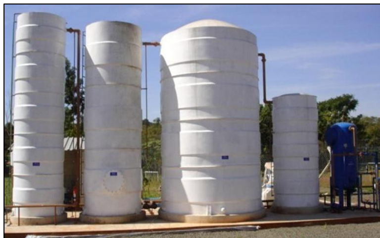
Figura 31 – Estação Compacta de Tratamento de Esgotos Sanitários.
