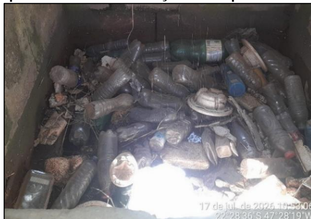
Figura 66 – Exemplo de falta de manutenção em dispositivos de microdrenagem.
